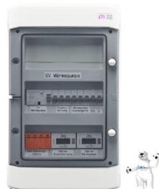
Kleinverteiler Wärmepumpe 3-Phasig
