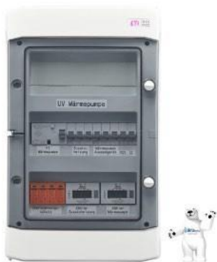
Kleinverteiler Wärmepumpe 3-Phasig
